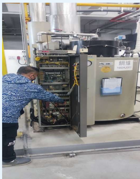
安全防護班訓練—關閉瓦斯鍋爐
