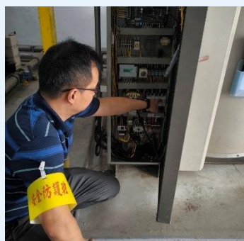
安全防護班訓練—關閉瓦斯鍋爐
